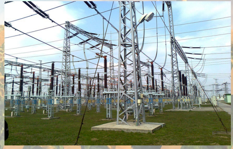
Exkurzia v rozvodni v Križovanoch nad Dudváhom
