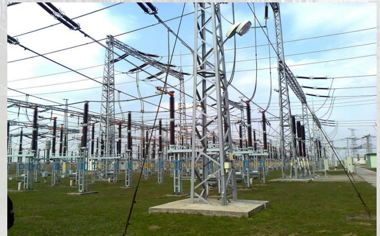
Exkurzia v rozvodni v Križovanoch nad Dudváhom
