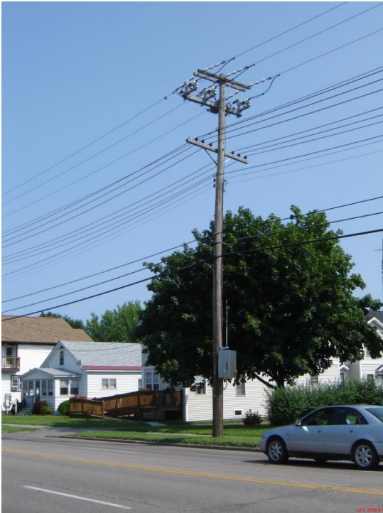
S&C Scada Mate Switch A1
