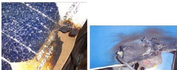
Obr. 2. Poškodenie FV panelu vplyvom blesku ( http://energy.sandia.gov )
