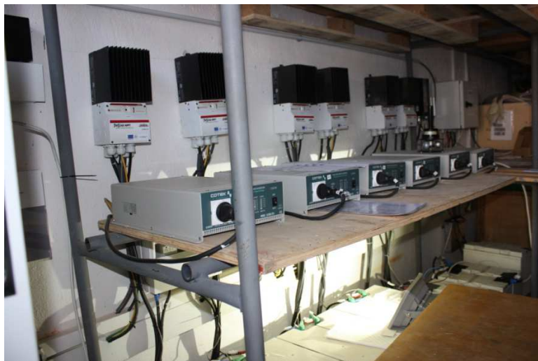
Obr. 17 Vnútorné zariadenia jednotlivých blokov v strojovni
